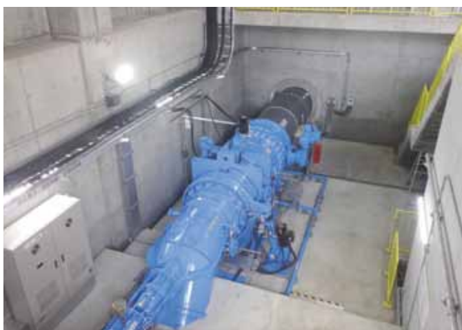
小水力発電施設内
